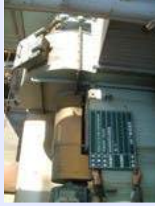
ボイラー用 押込ファン(EDF)
