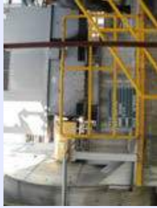
ボイラー用 誘引ファン(IDF)
