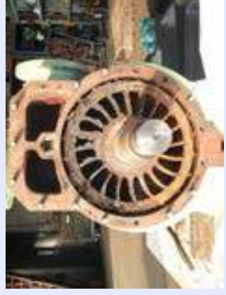
水封式真空ポンプ (内部)
