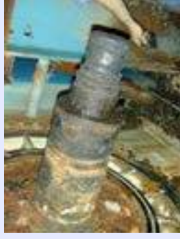
ジャーナル補修前
