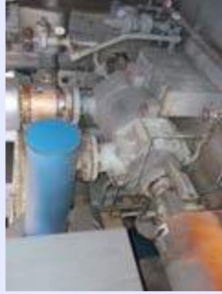
高圧ポンプ(ボイラー給水用)
