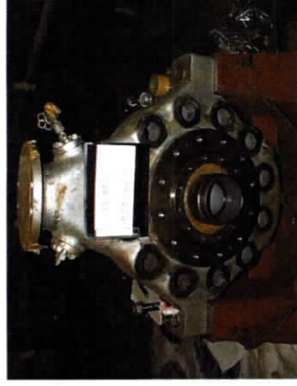
ボイラー給水ポンプ(O/H)
