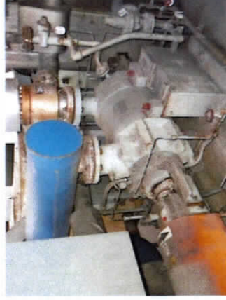
高圧ポンプ(ボイラー給水用)
