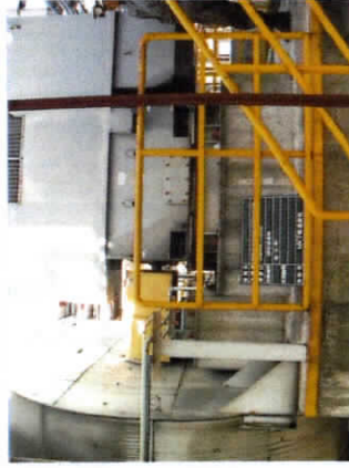
ボイラー用 誘引ファン(IDF)
