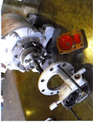
高圧ポンプ(O/H)
